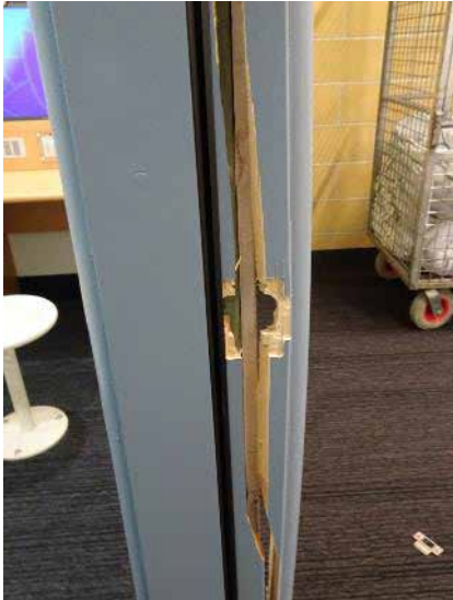
Damaged AVL suite door
